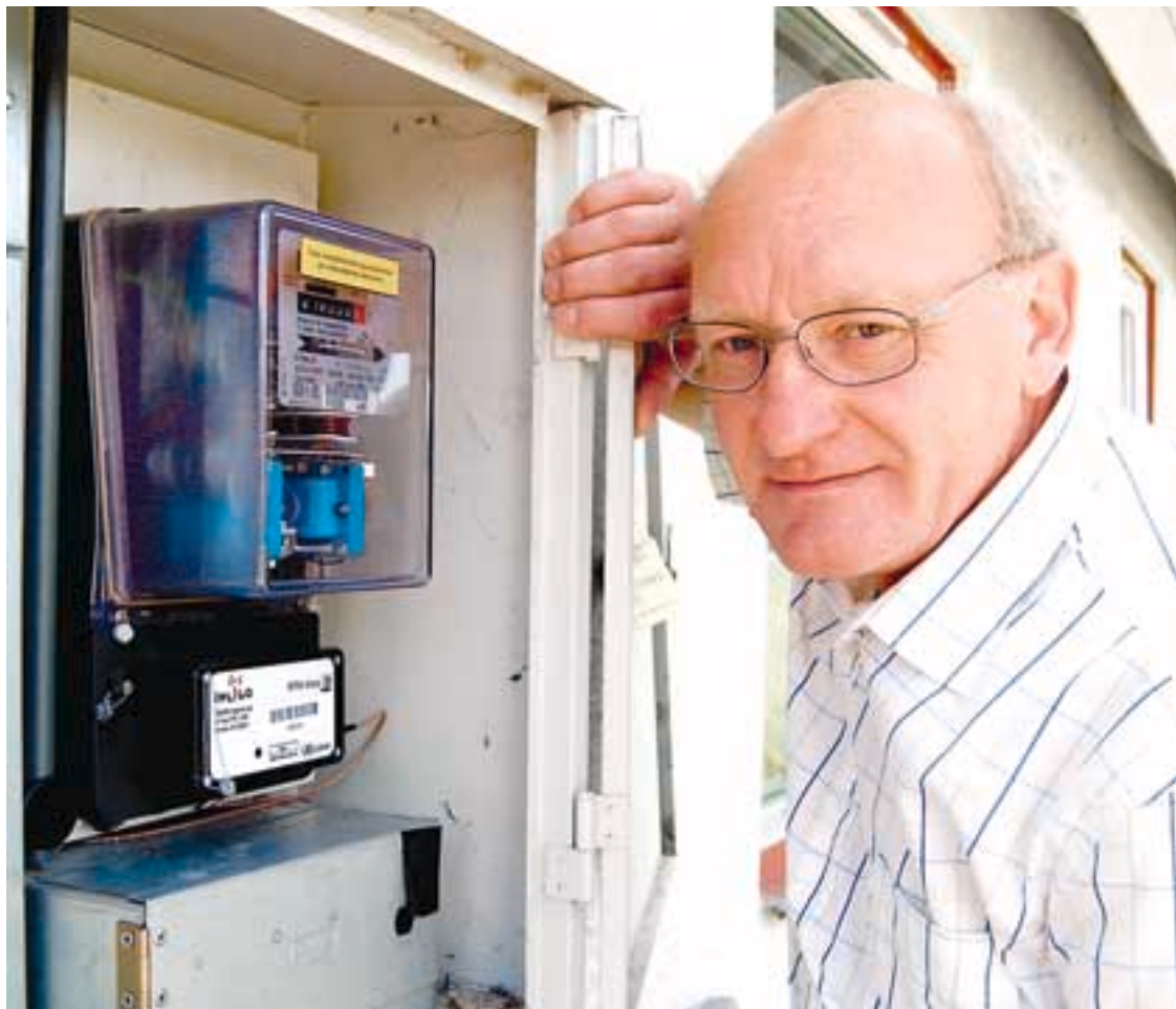
Sådana här agenter från WM-data testas av Staffanstorps Energi för fjärravläsning av mätarställningen. ”Det är olika förutsättningar varje gång vi monterar en agent”, säger Ove Göransson, vd i företaget. ”Det är därför viktigt att anläggningen fungerar direkt när agenten är på plats.” Foto: Berne Lundkvist.
